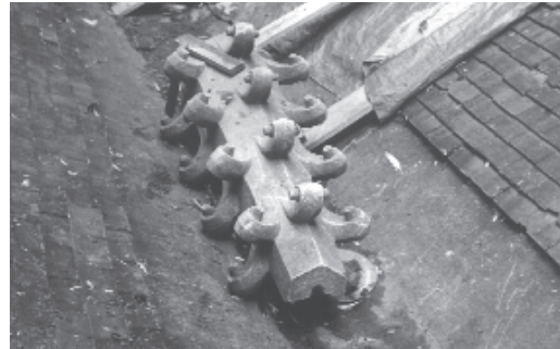
Pinnacle abattu lors de la tornade du 14 août 1999. Photo Pierre Halleux
